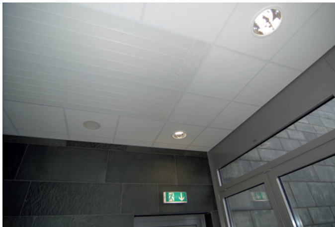
Bild 4: Deckenstrahlplatten im Eingangsbereich
