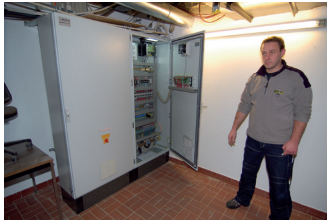
Bild 6: Das Herzstück der Haustechnik, der Schaltschrank
